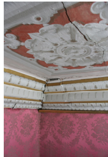
Im Toilettenzimmer der Kaiserin löst sich in einer Raumecke das Gesims von der Decke.
